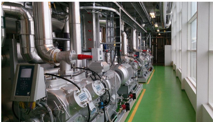
Fig 1. Heat pump, Grundfos, Gudenådalens Energiselskab
